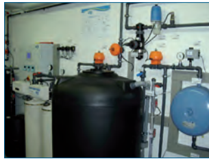
Trinkwasseraufbereitung / Drinking water treatment system utp umwelttechnik pöhl GmbH
