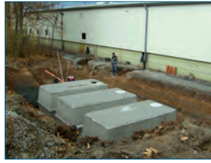
Stadtbauhof/ Public works department Regenwassernutzungsanlage 120 m 3 / Rainwater utilization plant 120 m 3
