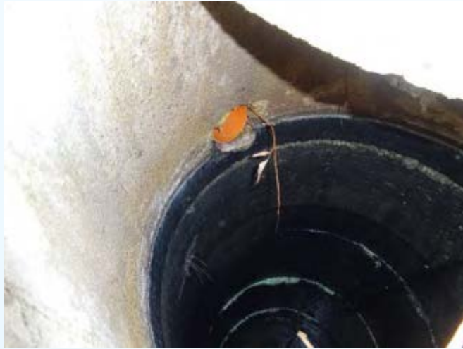
Überlauf aus Pumpenschacht in Graben
