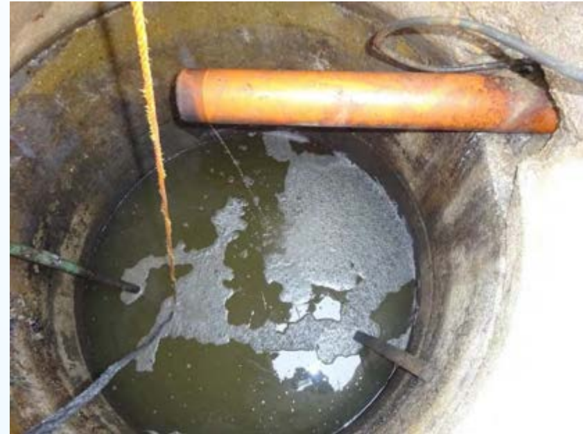
Pumpenschacht in Betrieb
