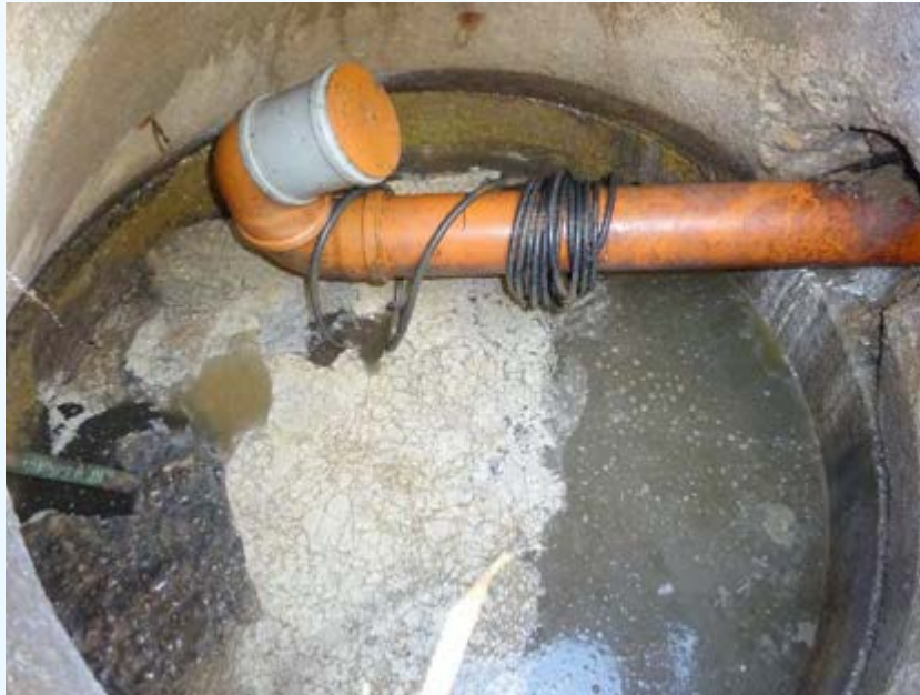
Verschlossener Zulauf zu Pumpenschacht
