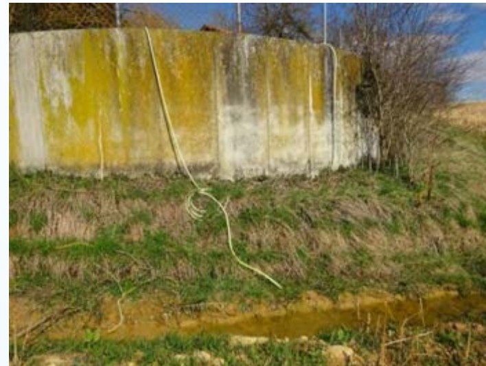
Über Schläuche entleerte Güllegrube von außen
