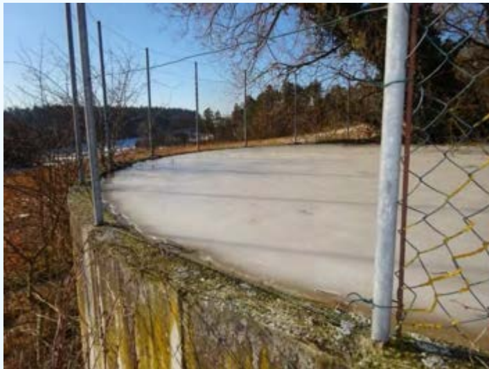
Volle/überlaufende ehemalige Güllegrube
