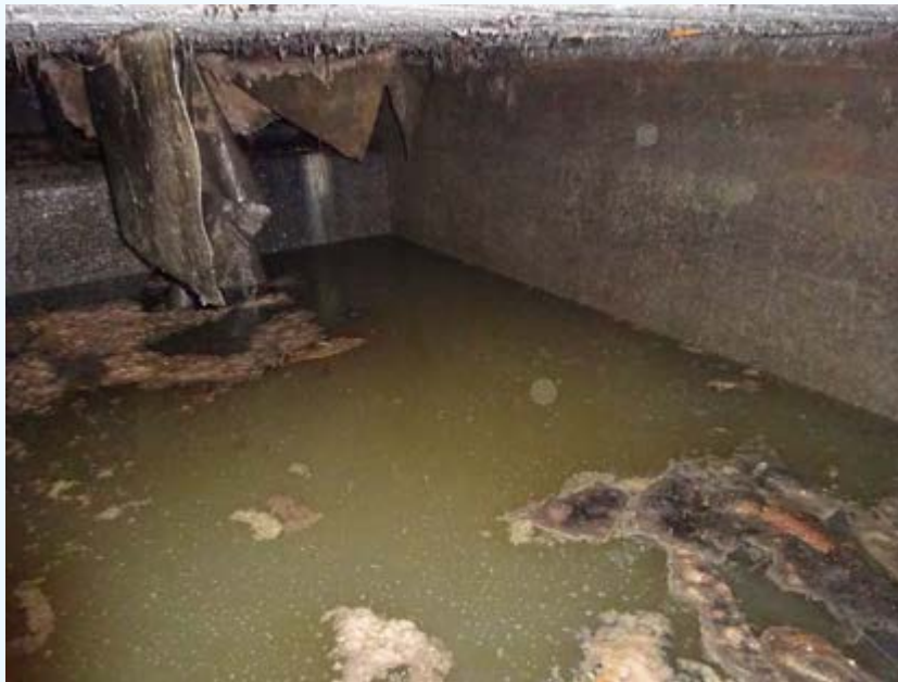
Fäkalschlamm und Hygieneartikel in abflussloser Grube
