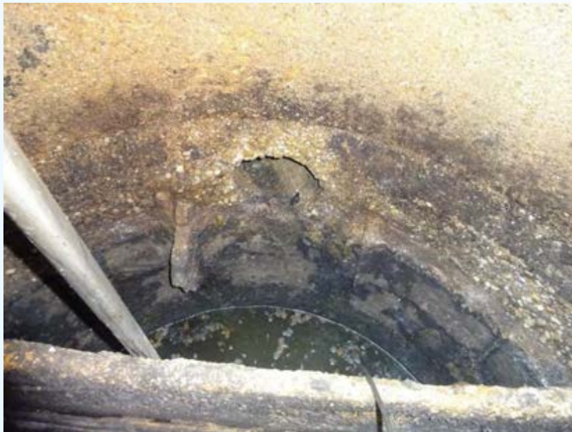
Notüberlauf in Pumpenschacht
