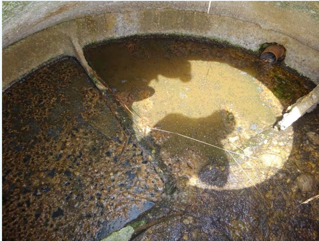
Trennwände der Vorbehandlung gebrochen
