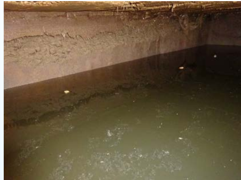
Großflächige Betonabplatzungen in der Wand der überbauten Güllegrube
