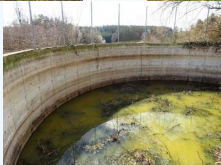
Über Schläuche entleerte Güllegrube von innen
