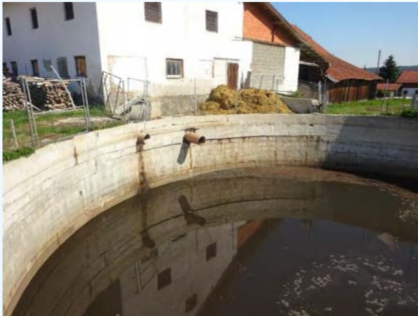
Risse in der Wand der oberirdisch aufgestellten Güllegrube
