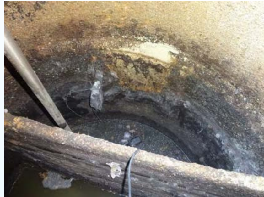
Verschlossener Notüberlauf in Pumpenschacht
