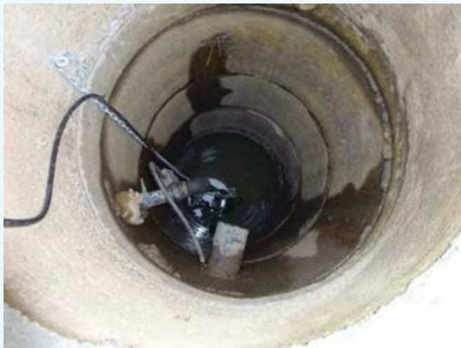
Pumpenschacht in Betrieb mit verschlossenem Notüberlauf
