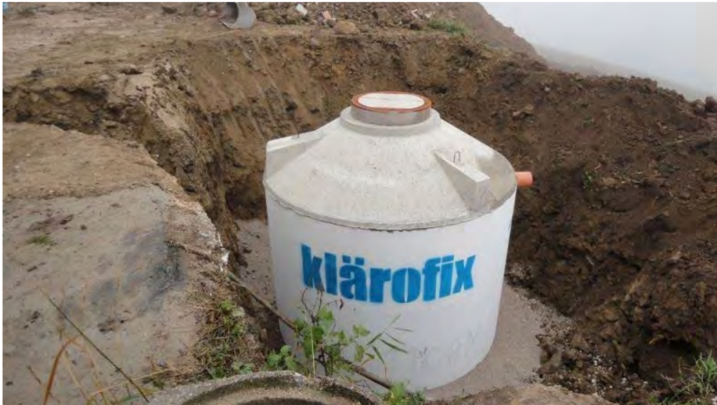
Bild: Österreich, Kleinkläranlage für 6 EW
